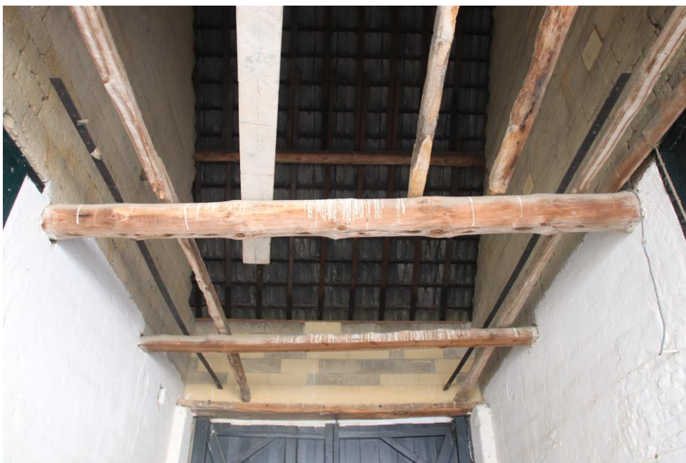
Foto 3: uitwerpselstrepen op de balken verraden de roestplek in het binnenste deel van het complex
