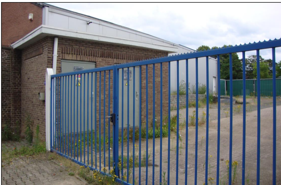
Binnenterrein met trafohuisje
