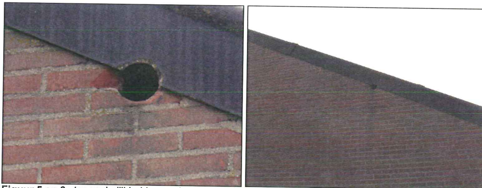
Figuur 5 en 6 toegankelijkheid voor vleermuizen tot spouwmuur
