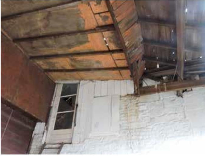
26. De hoek van beide bouwdelen is uiterst rommelig en ad hoc tot stand gekomen
