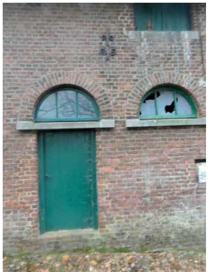
12. De deur is secundair, maar met behoud van de onderdorpel van het halfronde venster
