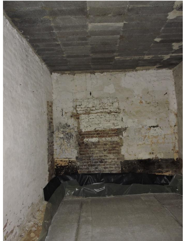
Figuur 19 Ook in de tweede waskeuken is weer een dichtgezette doorgang te zien
