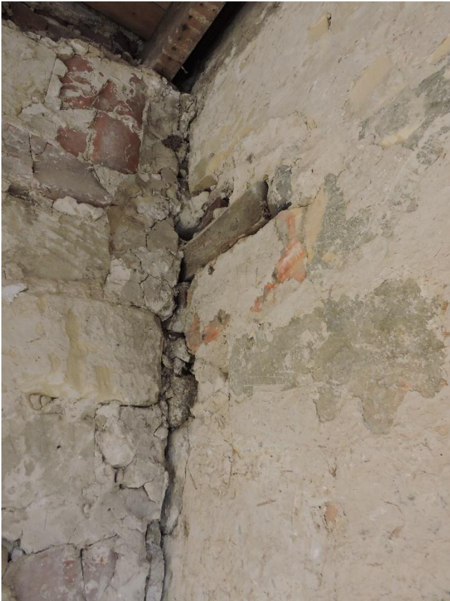
Figuur 8 De gebrekkige aansluiting op de muur van de belending met achter de muur een lateibalk van een voormalige doorgang
