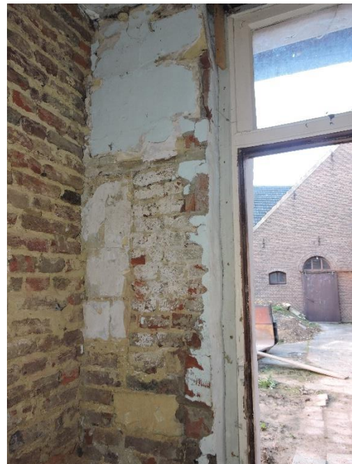
Figuur 21 Een reparatie in baksteen die laat zien hoe er op incidentenbasis werd gewerkt
