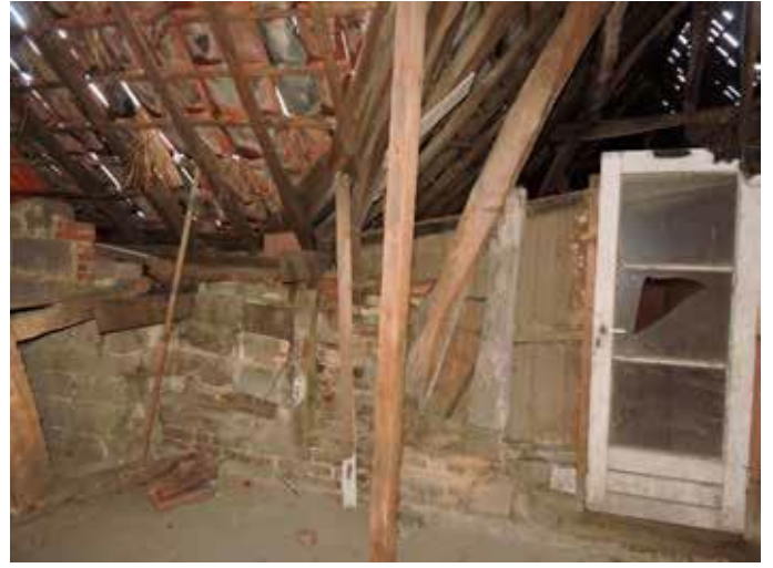
72. De overgang van de woonhuisvleugel op de oude stal is chaotisch en bestaat uit lapwerk.
