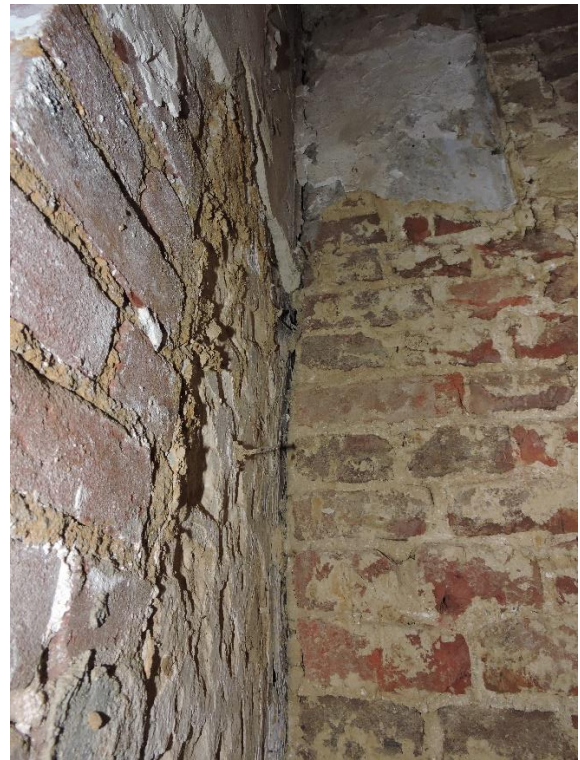
Figuur 12 De muur staat koud tegen het pleisterwerk van de buitenmuur
