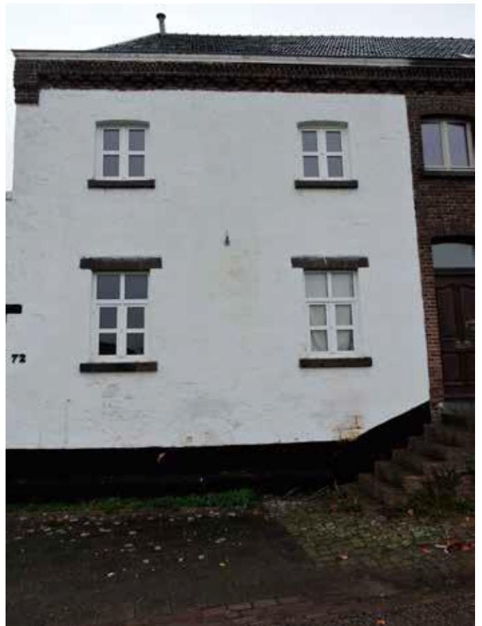
40. De voorgevel frontaal. De ramen zijn door de vorige eigenaar zonder vergunning vervangen in kunststof. Daarbij is de oude indeling niet correct gevolgd
