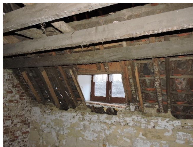
Figuur 33 Een ingebroken raampje in de laatste kamer
