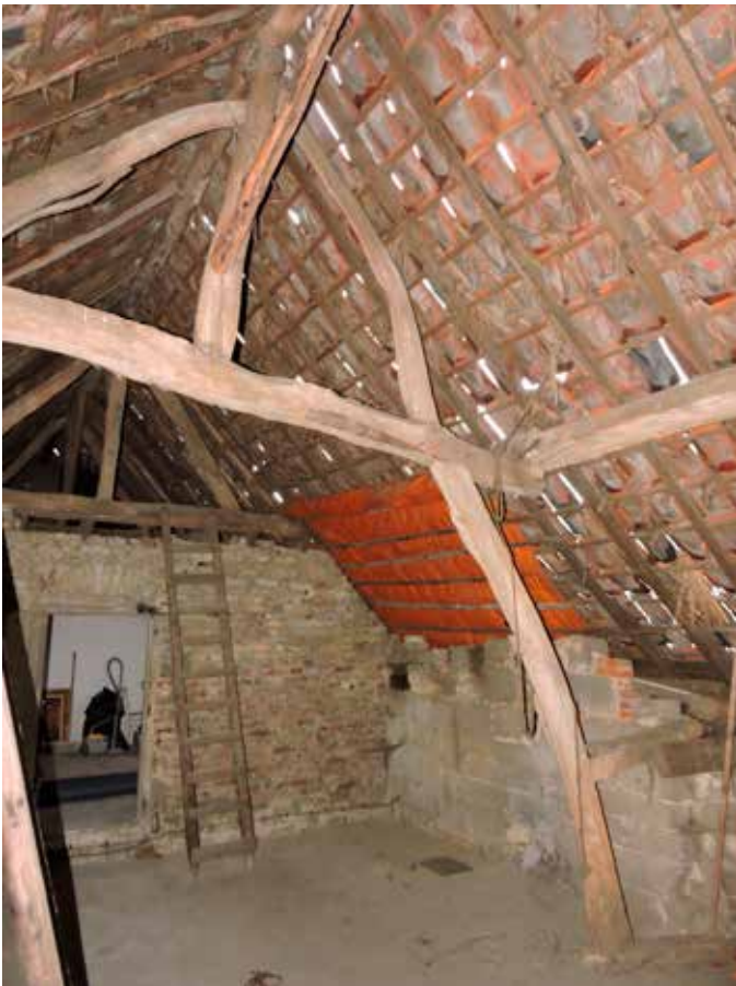
67. De kap van dit deel heeft 19 de eeuwse spanten die oudere constructies vervangen. Aan de muren in mergel is te zien dat de oude massa deels is vervallen zonder goede aanpassingen voor de opvang van de kepers van het dak
