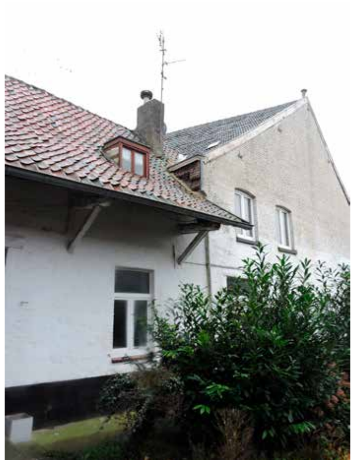
29. De aansluiting van de daken is enigszins problematisch
