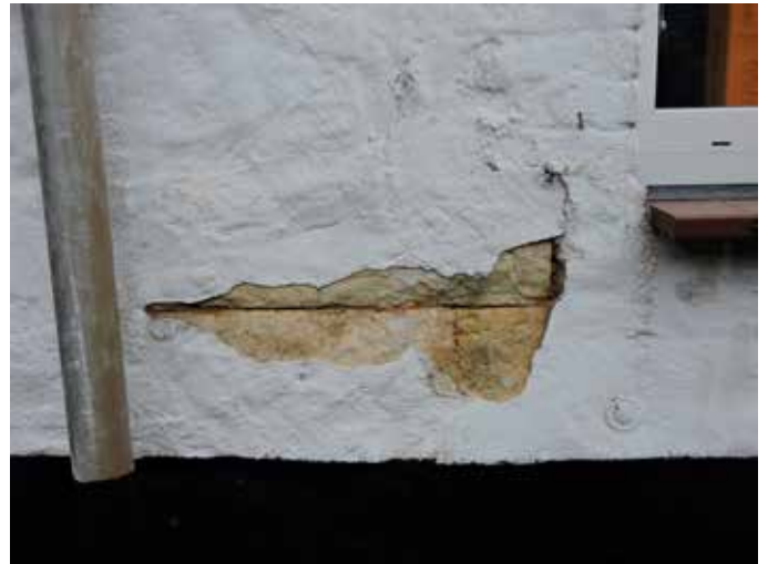
34. De mergel zelf is verstoppt achter dikke lagen kalk, op plaatsen gecombineerd met cement. Daardoor zijn veel stenen aangetast
