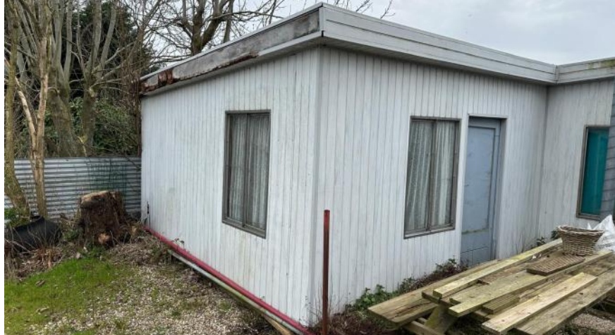
4. Diversiteit aan vervallen bouwwerken/recreatiewoningen op kavel
