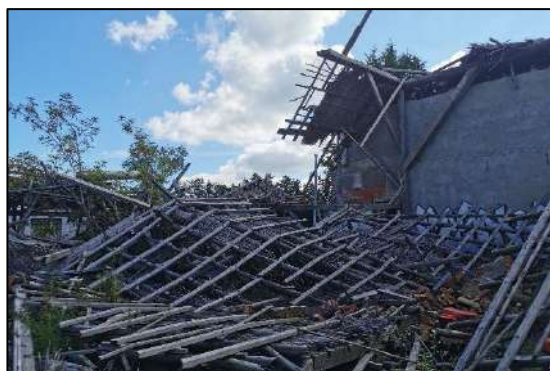
Figuur 2.4. Ingestorte dak van de stolpboerderij.
