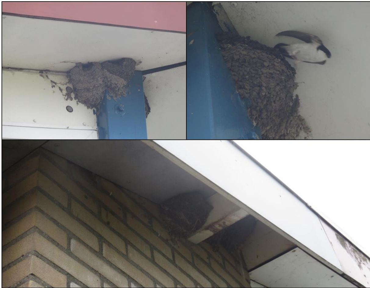
Figuur 2.3. Huiszwaluwnesten aan de zuidwest- en noordzijde van het zwembad.
