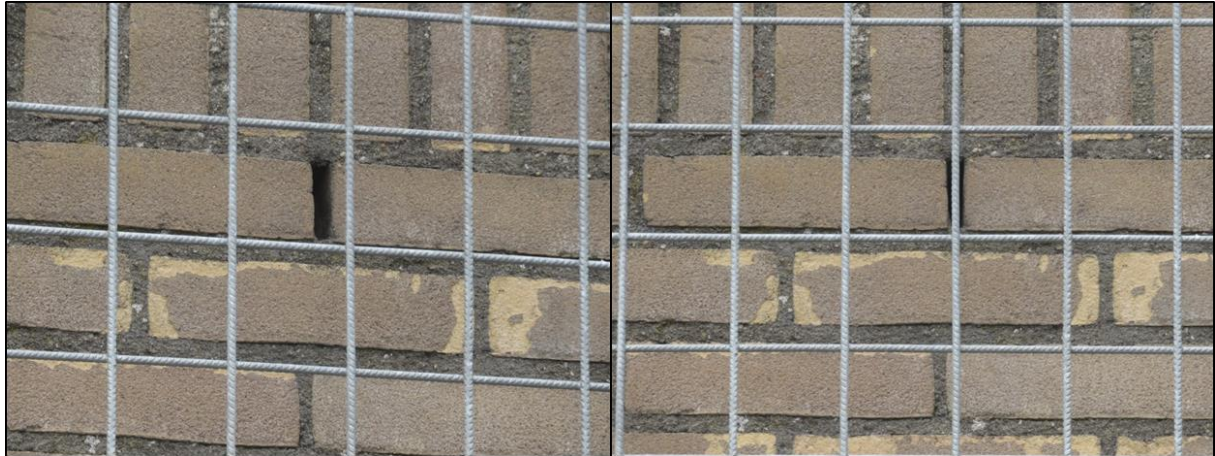
Figuur 2.6. Een stootvoeg naast de uit te breiden entree is niet toegankelijk door de aanwezigheid van een metalen frame.
