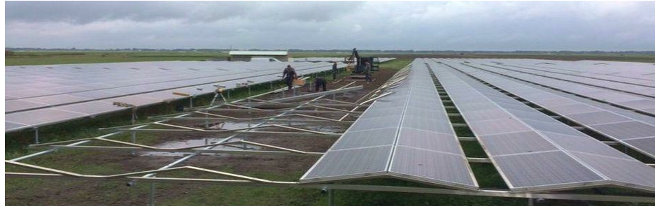
Zonnepanelen: type Full Black - Oost-West opstelling. - Hellingshoek 10 graden. - Afstand tussen de panelen 0,8 meter. - Aantal panelen 9500 stuks. Totaal 2,66MWP.
