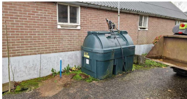
Figuur 10: Bovengrondse dieseltank
