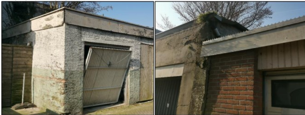
Figuur 2.5 (links): Impressie van de voorzijde, gezien vanaf zuiden; Figuur 2.6 (rechts): Overgang tussen de garageboxen in slechte staat en garageboxen in redelijk slechte staat van onderhoud.
