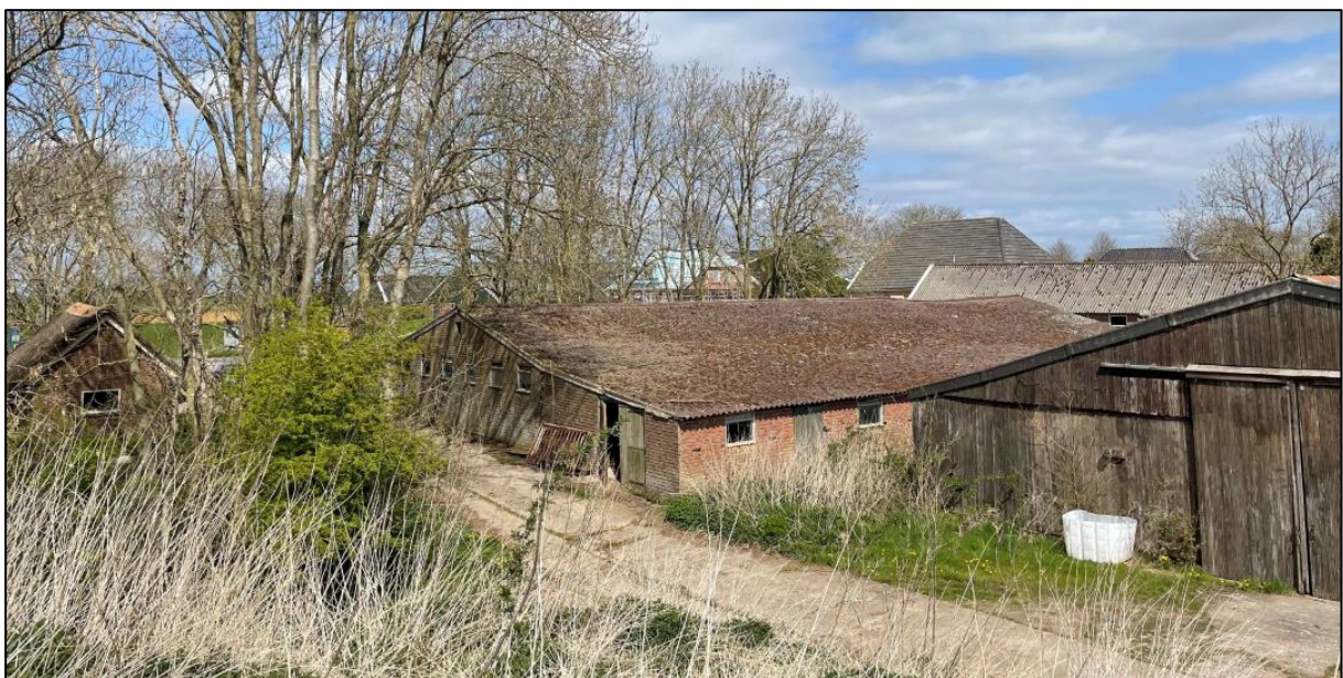
Zicht op de voormalige agrarische bebouwing die in slechte staat verkeert.
