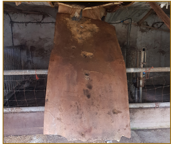
Afb. 2.8: Krabsporen van marter op de loshangende isolatieplaten in de stal.
