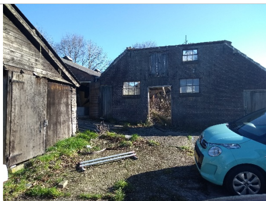
Foto 7: Buitzijde van de vervallen veestallen naast en achter Cellemuiden 41. Deze gebouwen worden gesloopt en er worden woningen gerealiseerd.
