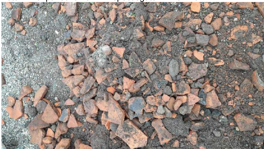
Foto 2: Dakpanscherven in inspectiegaten A4 en A5
