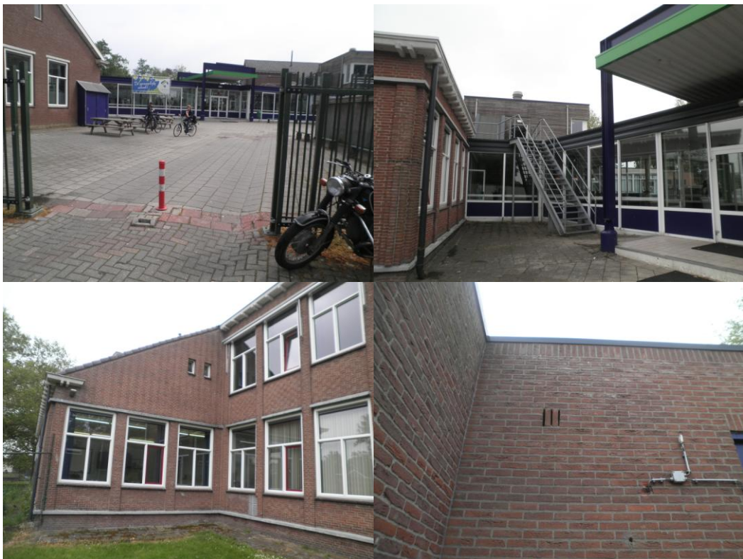
Foto's 1 t/m 4. Delen van de gebouwen van het Agnieten College in Zwartsluis tijdens het veldbezoek op 30 mei 2013 (foto's A&W).
