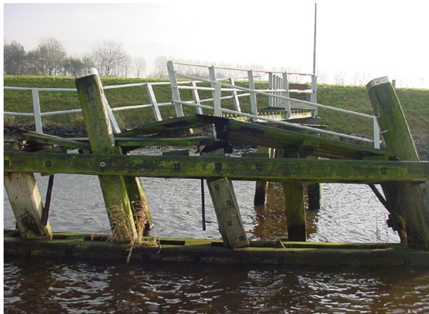
..... Figuur 3.10 Kapotte steiger aan de Zwarte Waterzijde van de Meppelerdiepsluis na aanvaring door binnenvaartschip
