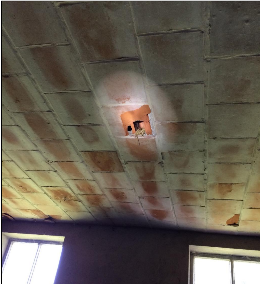
Figuur 5. Nest van een vogel in een beschadigde plafondplaat
