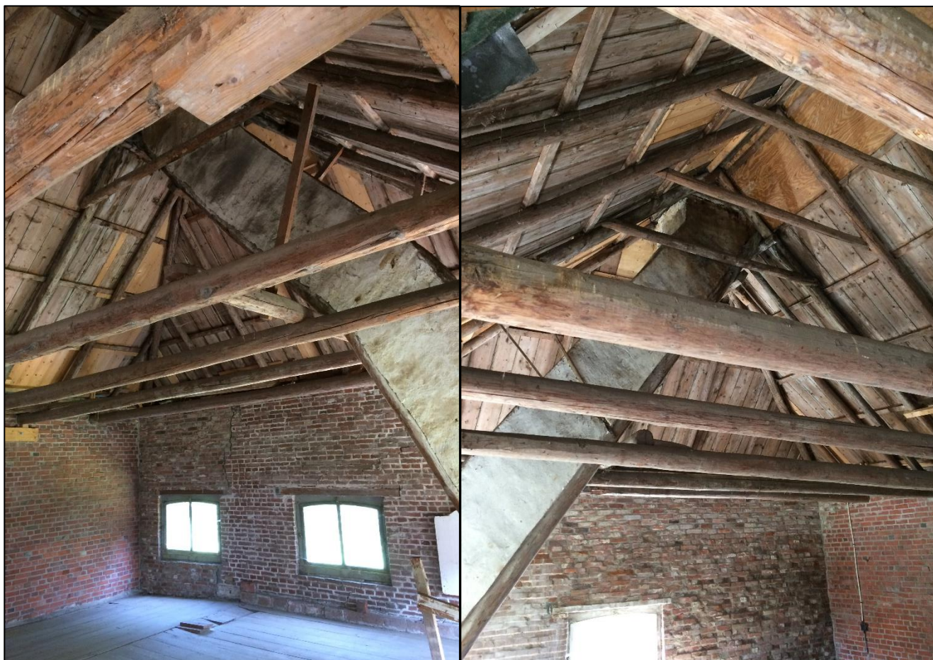
Figuur 4. Te vervangen dakbeschot aan de binnenzijde van de woning
