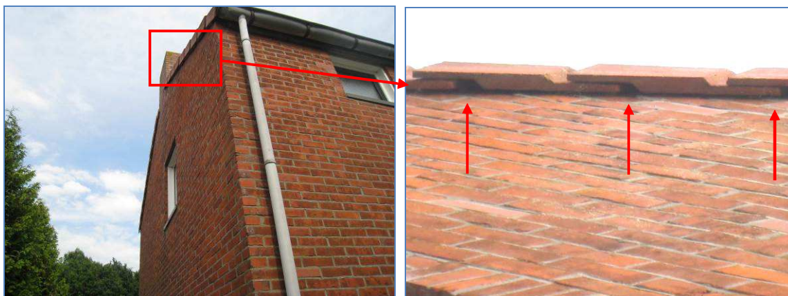
Figuur 4. Potentiele invliegopeningen van vleermuizen om onder het dak te komen of in de spouwmuur.
