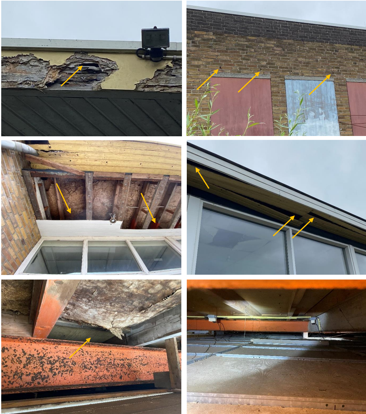
Figuur 6 Boven links: kapotte gevel aan de zuidkant met opening. Boven rechts: open stootvoegen aan de zuidkant (waarschijnlijk te smal voor vleermuizen). Midden: ontbrekend en loszittend plaatwerk aan de westkant van het pand eventueel ingang voor steenmarters. Onder: dakruimte naar systeemplafon aan de westkant. De pijlen geven potentiële invliegopeningen voor vleermuizen weer. Foto's: Bureau Biota.
