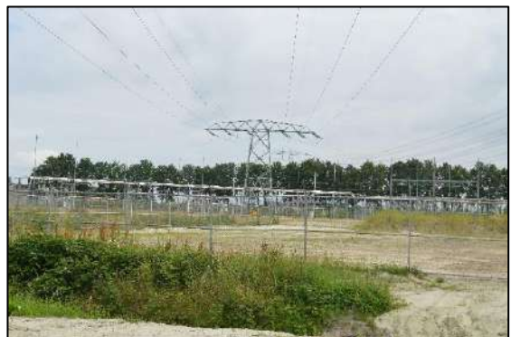
Afbeelding 2.13. Bestaande Tennet station ten zuidoosten van Meeden.
