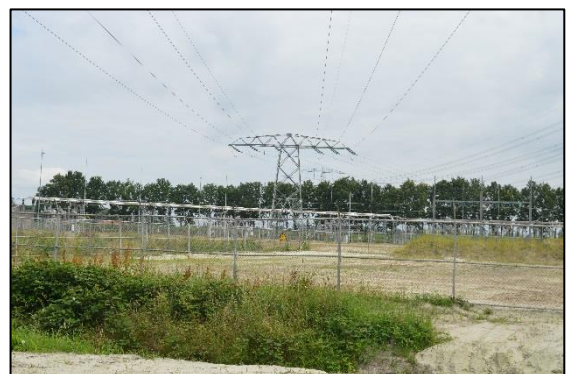
Afbeelding 2.13. Bestaande Tennet station ten zuidoosten van Meeden.
