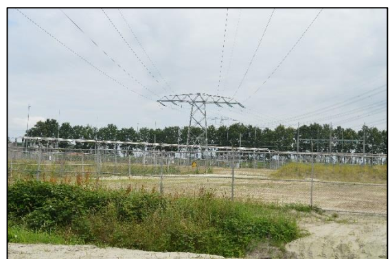
Afbeelding 2.13. Bestaande Tennet station ten zuidoosten van Meeden.
