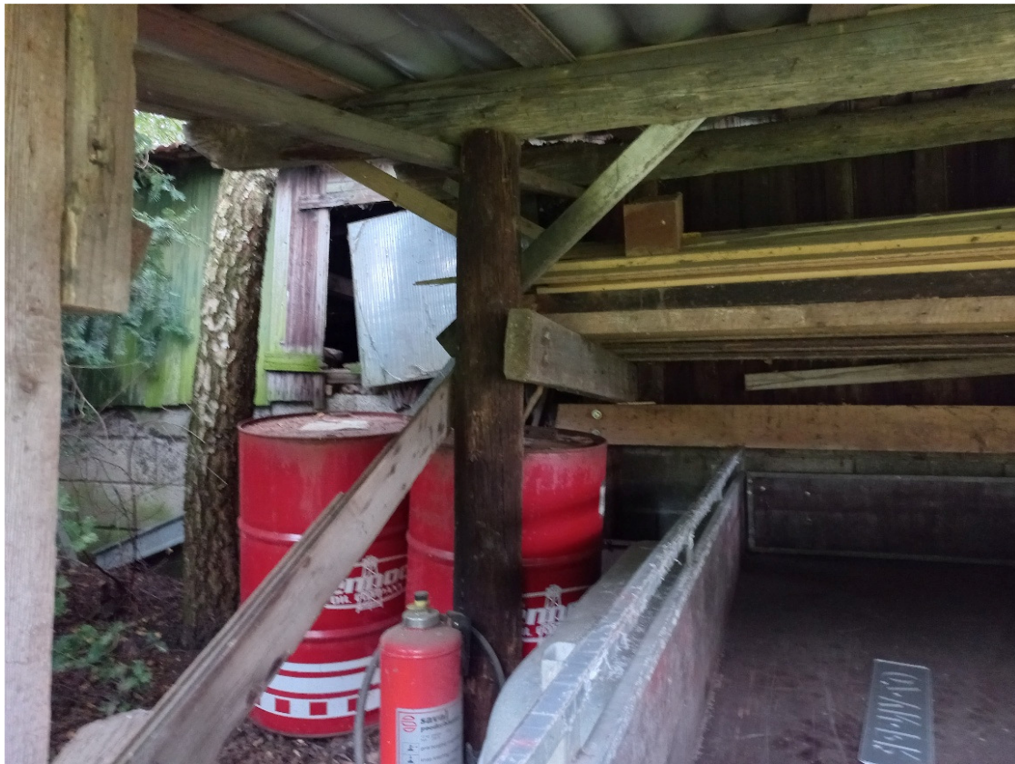
Aangetroffen oliedrums onder overkapping
