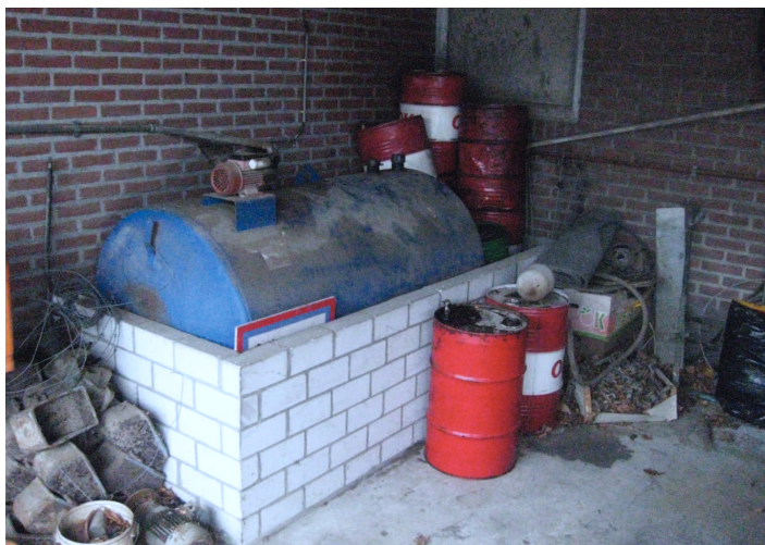
Foto 4: bovengrondse dieseltank (1.200 liter)
