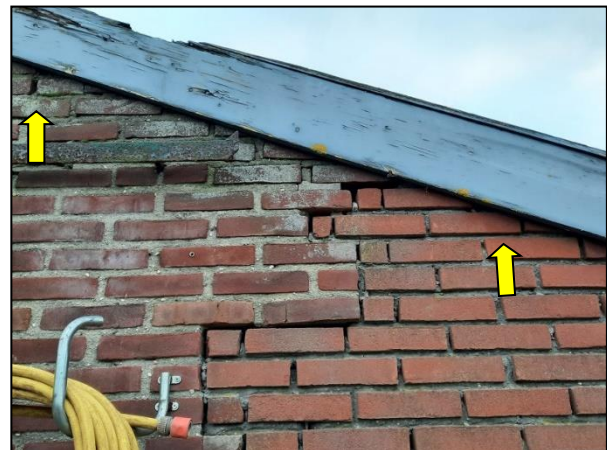
Figuur 15. Geschikte kieren en spleten in muur en onder betimmering.
