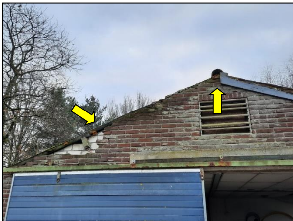
Figuur 14. Geschikte gaten en openingen die leiden naar spouwmuur en zolderruimte.
