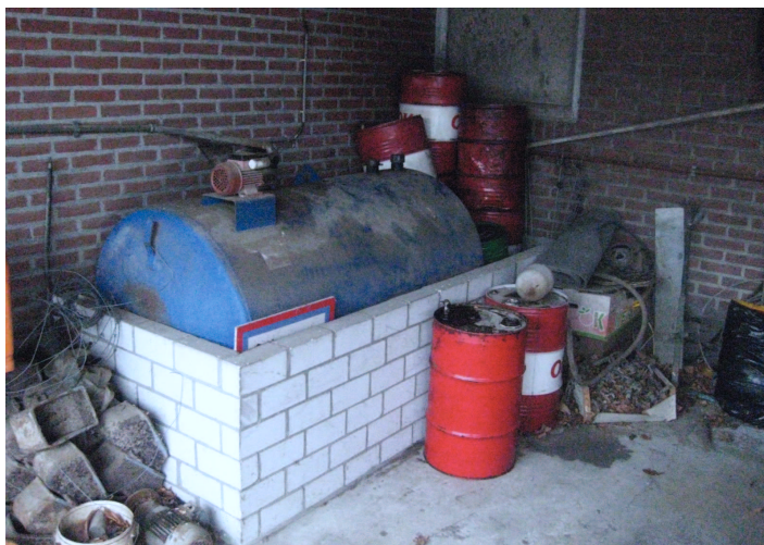
Foto 4: bovengrondse dieseltank (1.200 liter)
