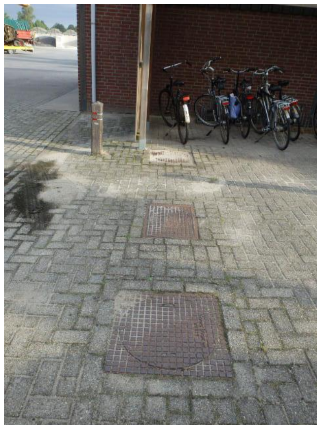
Foto 4: olie- / benzine-afscheider (gezien vanuit het zuiden, 2 september 2015)
