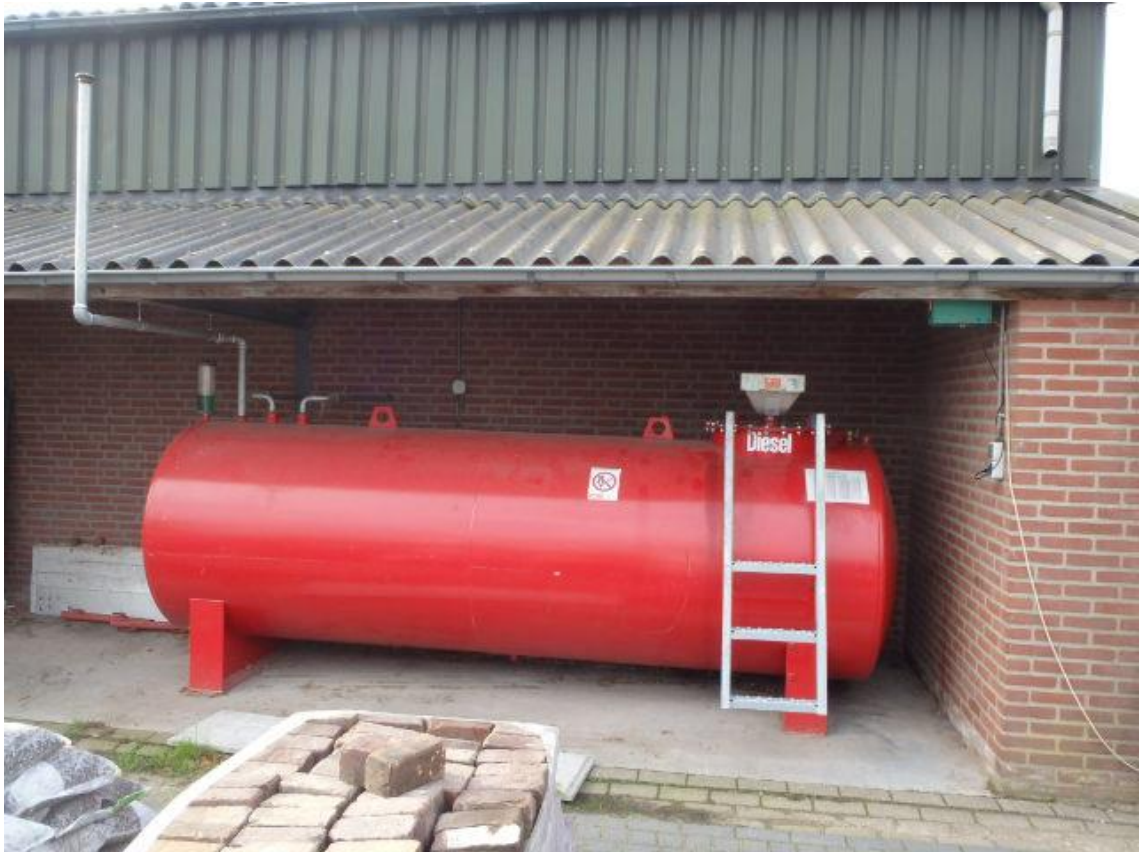
Foto 1: dieselininstallatie (gezien vanuit het noorden, 2 september 2015)
