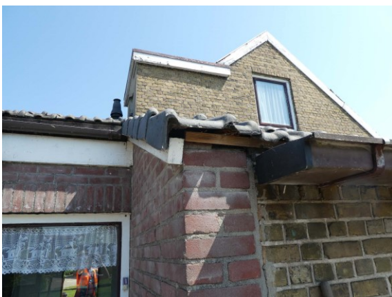
Figuur 14 Verrotte opening aansluiting
