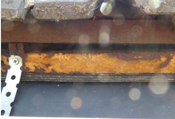
Figuur 16 Opening tussen dak en isolatiemateriaal
