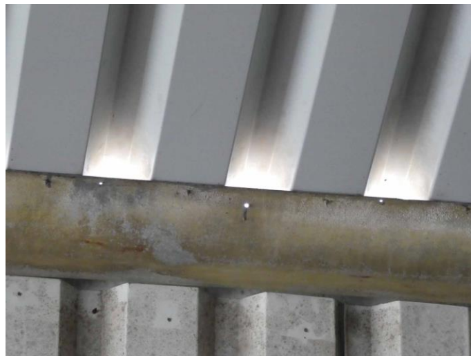
Figuur 10: Overgang dak en achterwand met openingen waardoor tocht ontstaat
