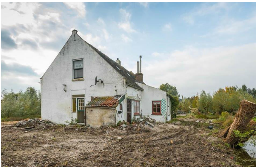
Afbeelding 3: Vervallen woningen 's-Gravenweg 51 te Nieuwerkerk a/d IJssel
