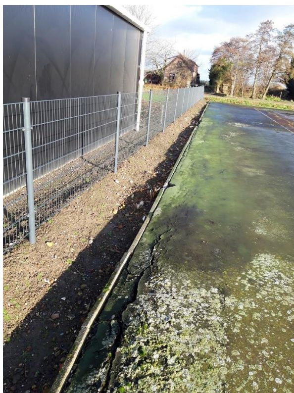
Foto F2 puin rand tennisbaan
