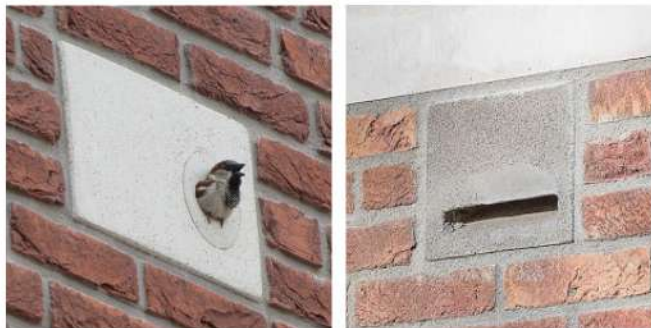
Vogel- en vleermuiskasten in de gevel
