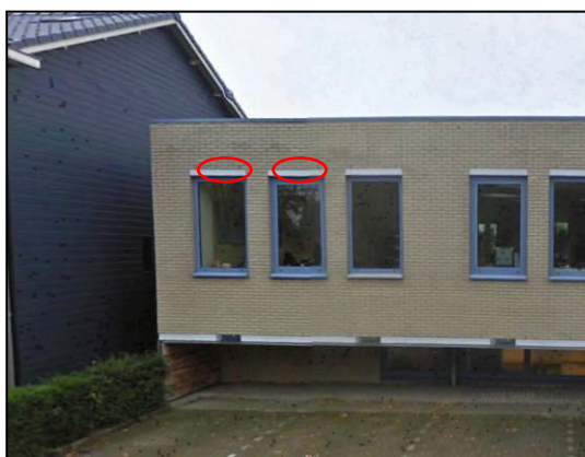
Foto 4. Invliegopeningen open stootvoegen kraamverblijf, Dorpsstraat 36
