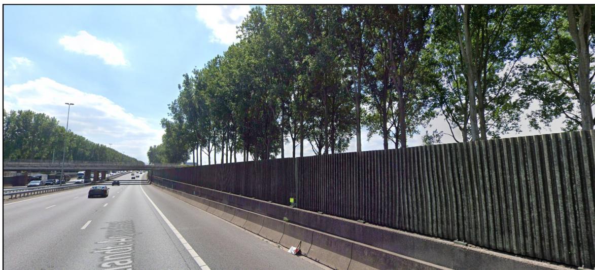
Figuur 4.1: Geluidsscherm rijksweg A20 ter plaatse van de planlocatie
