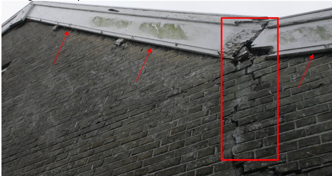
Foto 8 gaten en kruipruimten achter boeiboorden
