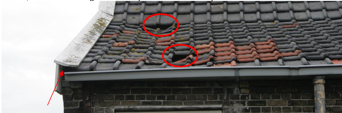
Foto 9, voorbeeld van gaten in het pannendak en kruipruimte achter boeiboord
