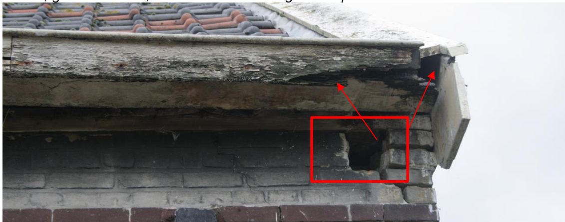
Foto 7, gat in de muur, vervallen aftimmering en kruipruimte achter boeiboord
