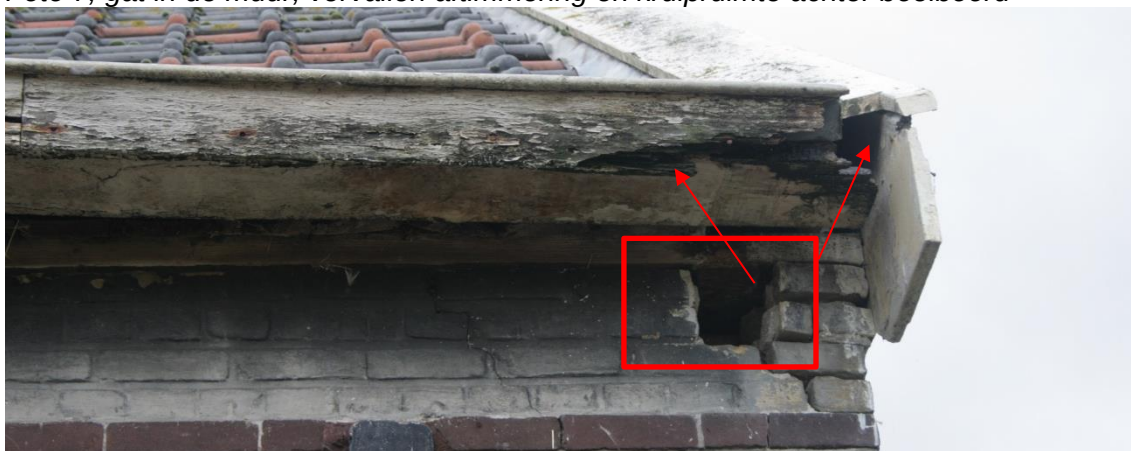
Foto 7, gat in de muur, vervallen aftimmering en kruipruimte achter boeiboord
