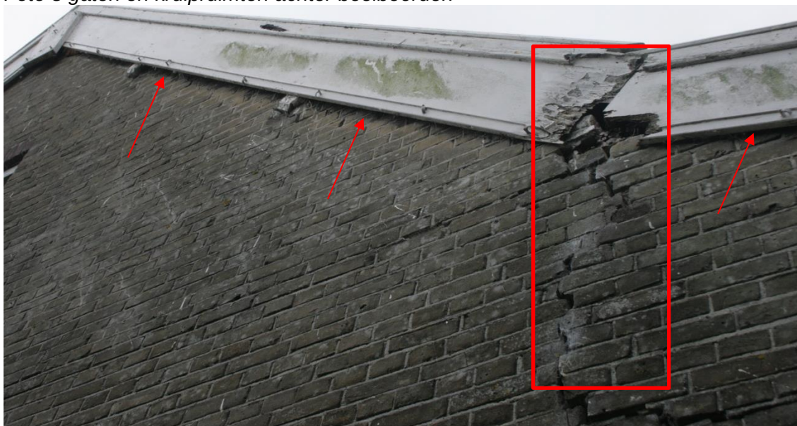
Foto 9, voorbeeld van gaten in het pannendak en kruipruimte achter boeiboord
