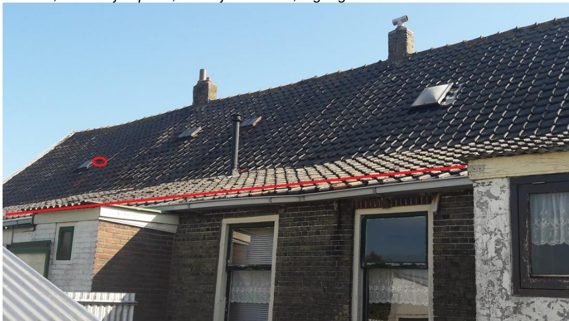
Foto 13, achterzijde pand; rode lijn en cirkel, ingangen huismussennesten
