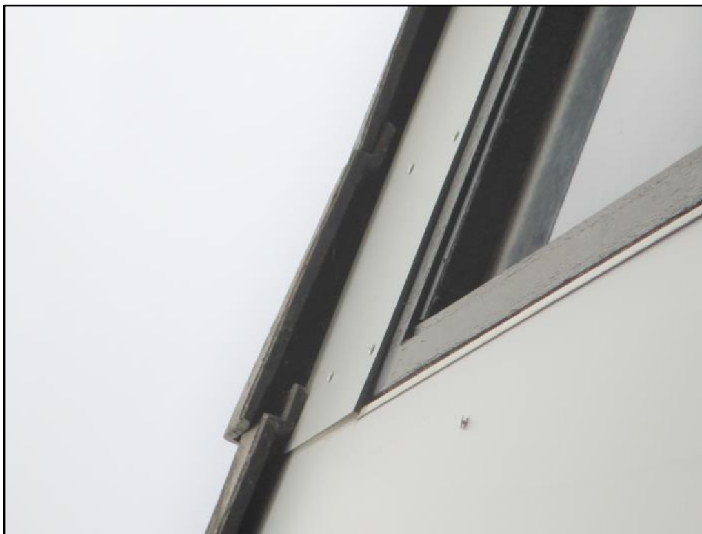
Figuur 4 De kantpannen van de kopgevel van het restaurant. De trespa-platen zijn dermate glad dat vleermuizen hier geen houvast kunnen vinden.
