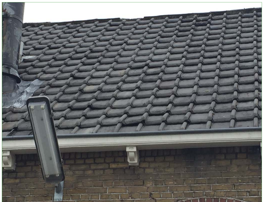
Scheefliggende dakpannen van het woonhuis kunnen toegang geven aan Gierzwaluw en/of vleermuizen. Het woonhuis wordt niet betrokken bij de plannen.
