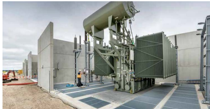
Transformator in betonnen ombouw
