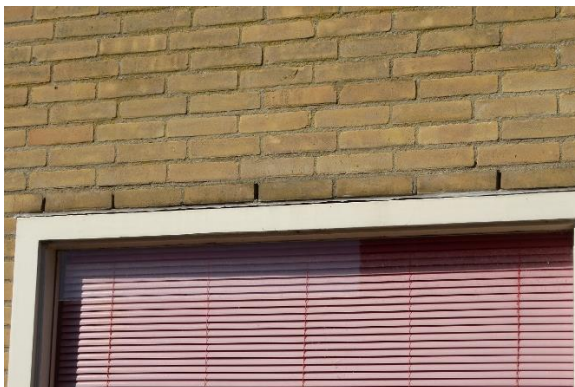
Figuur 3: Op meerdere locaties in de gevels zijn open stootvoegen aanwezig.
