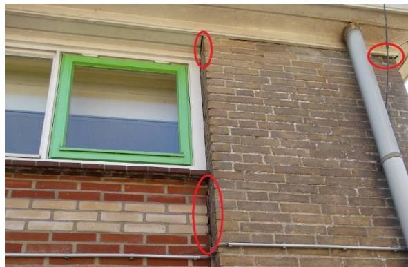
Figuur 4: In de gevel is missend voegwerk aangetroffen.
