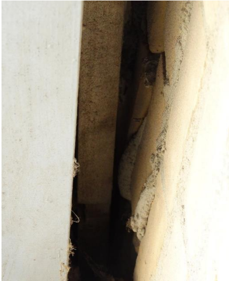
Figuur 5: Onder de dakoverstek zijn hier en daar ook spleten aanwezig.
