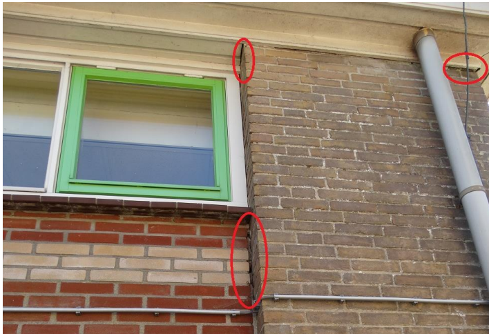
Figuur 11: In de gevel is missend voegwerk aangetroffen.
