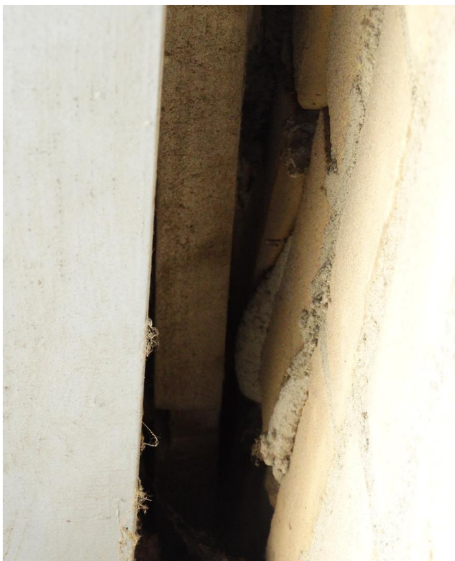
Figuur 12: Onder de dakoverstek zijn hier en daar ook spleten aanwezig.
