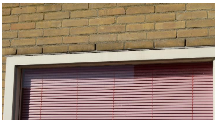
Figuur 10: Op meerdere locaties in de gevels zijn open stootvoegen aanwezig.
