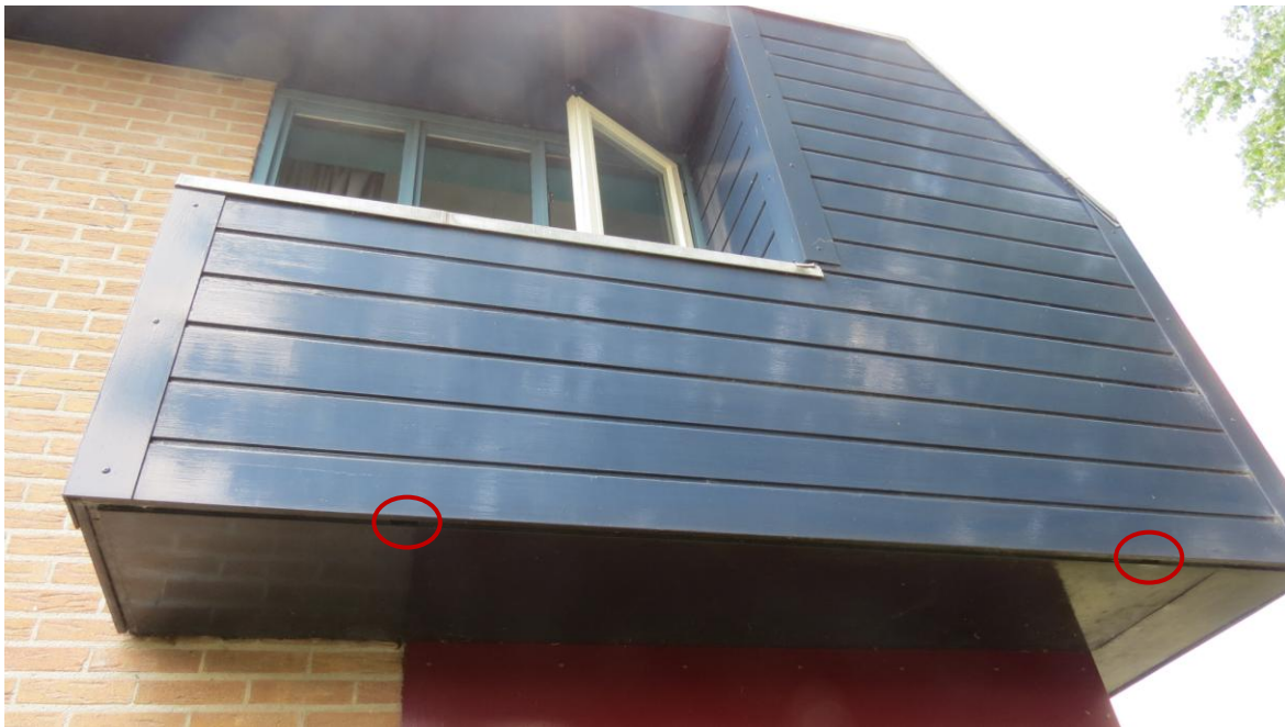
Foto 1: openingen (rode cirkels) in de houten betimmering aan de buitenkant van de gebouwen van het zorgcomplex (Foto: A&W).
