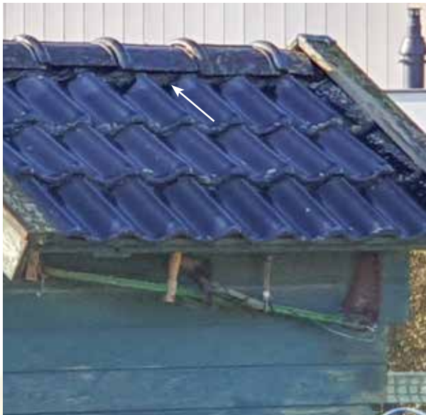
Figuur 9. Het kleine hokje met dichtgemetselde nokpannen.
