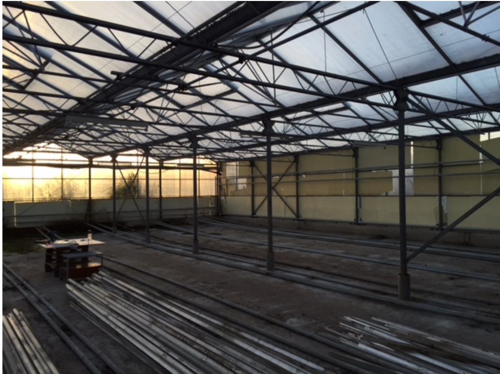
Figuur 3 De bedrijfsvoering is geruime tijd gestaakt. De huidige eigenaar is de opstallen aan het saneren.
