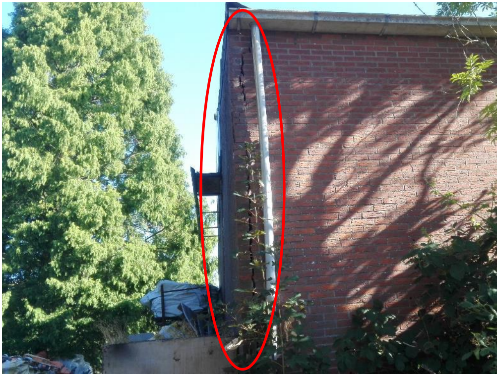
Figuur 3 De bebouwing bevat aan de achterzijde een ruime scheur die zich in verticale richting van de gevel begeeft. Mogelijk geeft deze scheur toegang tot de spouwmuur. Door de aanwezigheid van gegolfde folie in de spouw, blijft er te weinig ruimte over vleermuizen. De vrije ruimte is minder dan 1,5 tot 2 centimeter, hierdoor zullen ze altijd de buitenmuur raken, wat zeer ongunstig is voor een verblijfplaats.
