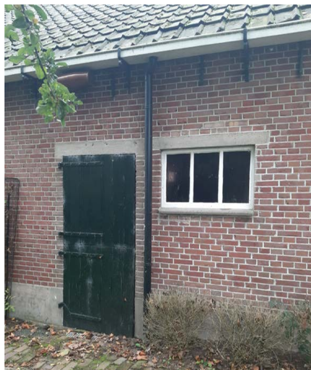
Afb. Rechtergevel van het zomerhuis. In een secundaire bouwphase (XXA) ingebrachte loopdeur met zijraam. Vlak onder de goot een ingemetselde grespijp, wellicht ooit bedoelt om met natuurlijke trek de stal extra te ventileren.
