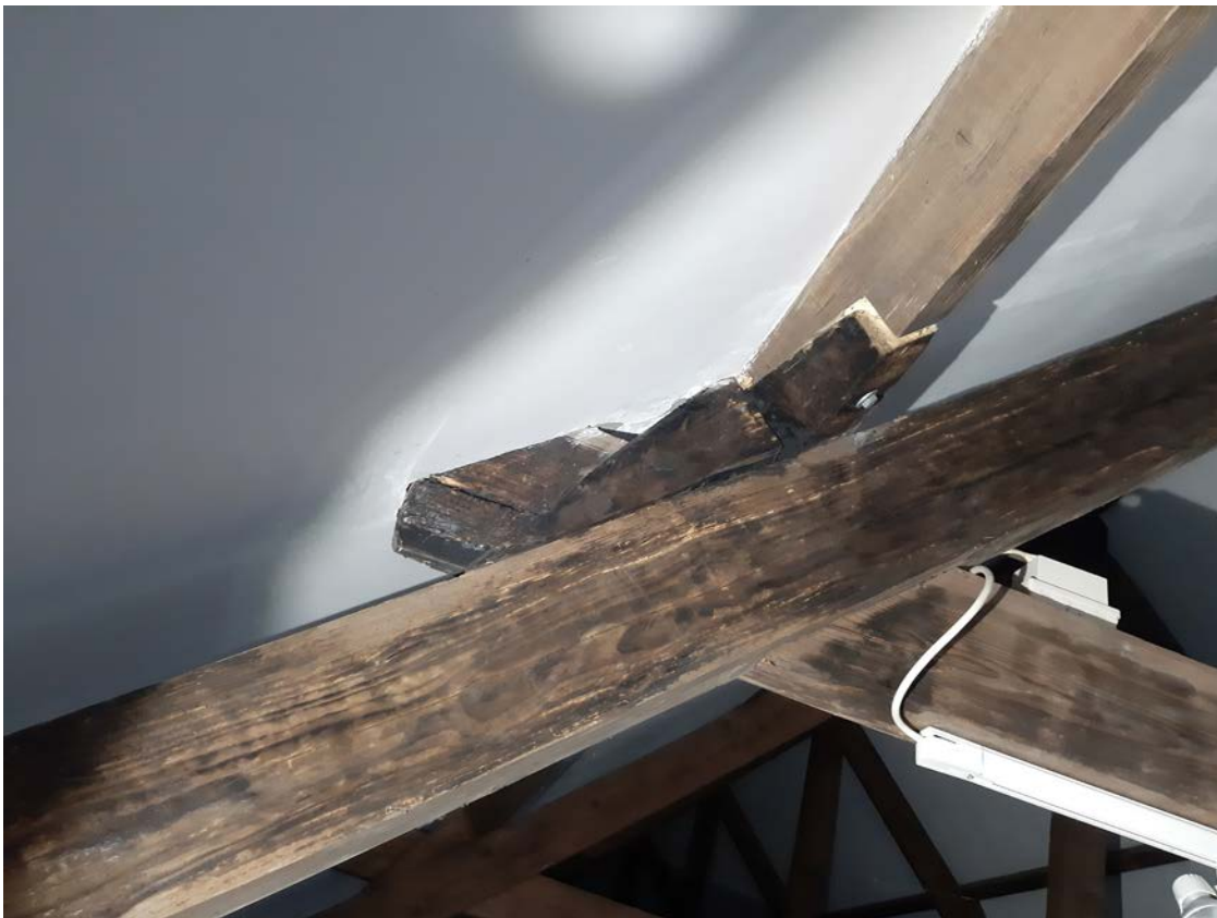
Afb. Spant in het achterste travee van het achterhuis. Duidelijk zichtbaar zijn de sporen van de brand uit 2018 en de aangebrachte herstellingen.
