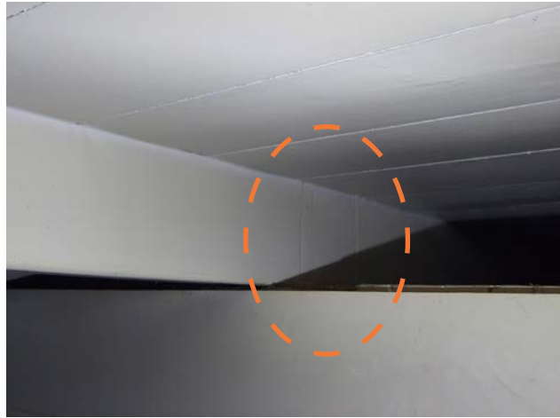
Afb. Bouwsporen op zolderbalk van de weggebroken scheidingswand.
