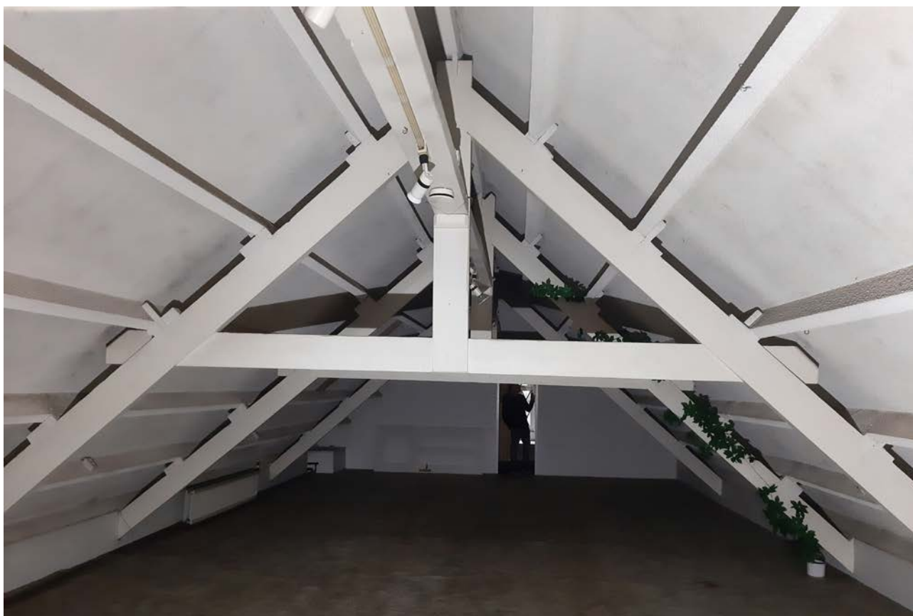
Afb. Nokstijlspanten in het zomerhuis. Duidelijk zichtbaar is dat de nokstijlen verzaagd zijn en de godingen zijn vervangen.
