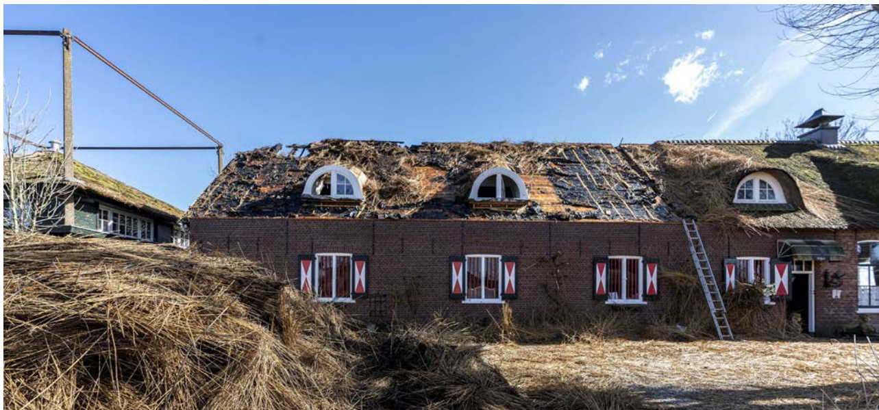
Afb. Foto bij krantenbericht Leids Dagblad d.d. 20 maart 2018. Goed zichtbaar is het geblakerde dakbeschot en deels verbrande kapconstructie. Fotograaf: H. Kuipers
