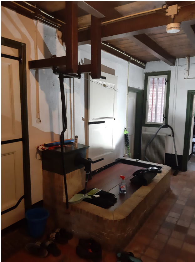
Afb. Pomp met waterbak in de werkkeuken in de boerderij.
