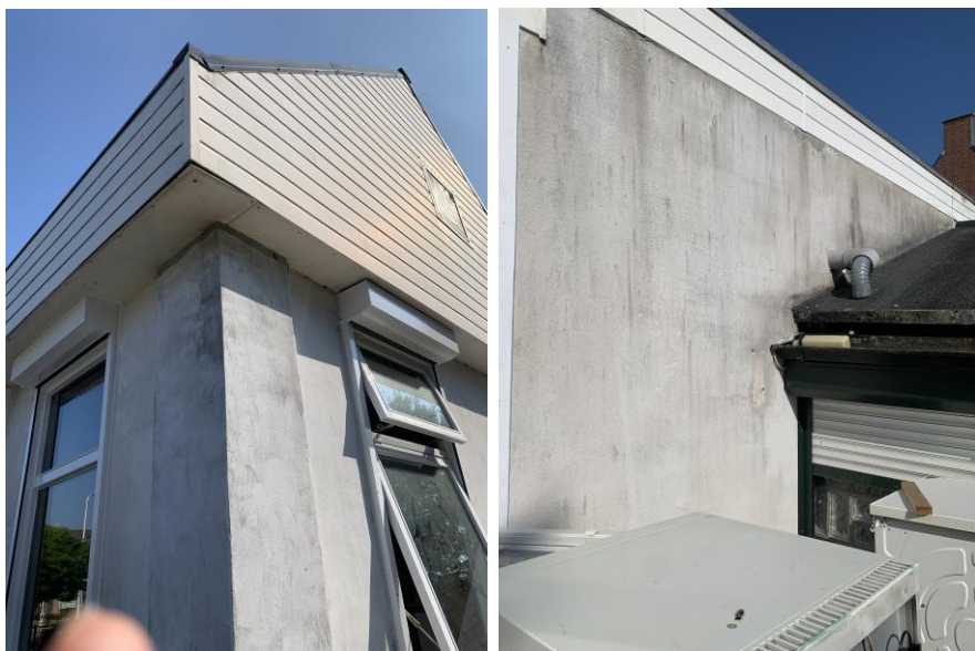
Afbeelding 8 en 9: Scheuren in het stucwerk zijn niet aangetroffen. Bron: R.J.L. Bijvelds 05-06-2020
