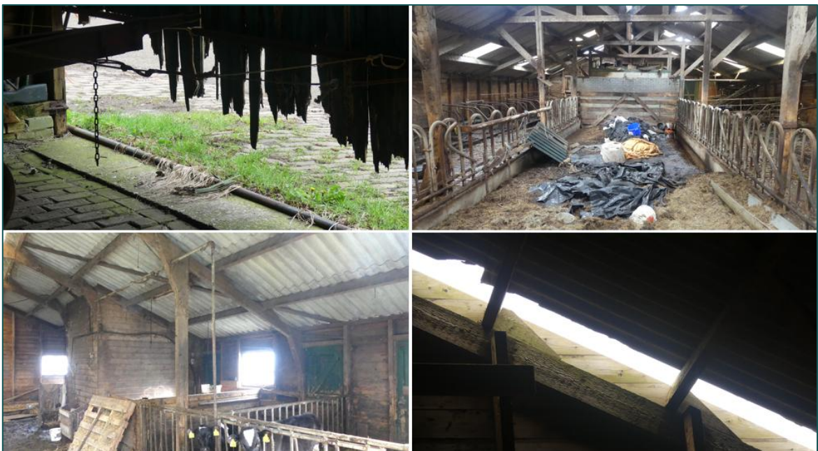
Figuur 3.1 Een impressie van beschadigingen aan de bebouwing (linksboven en rechtsonder) en lichtinval door lichtstraat en (ontbrekende) dakramen.
