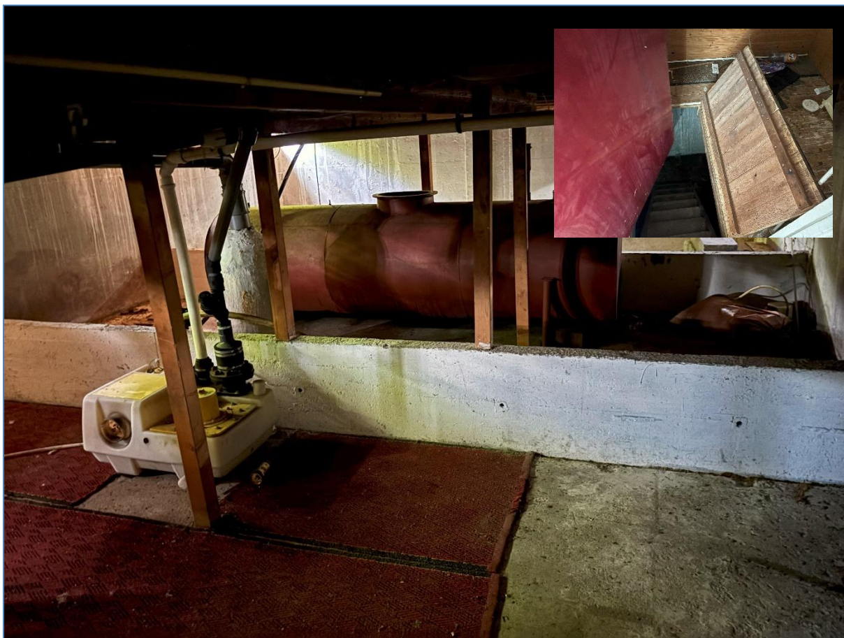
Afbeelding 6: kruipruimte onder de woonark met boiler of waterfiltersysteem o.i.d. in het midden. Toegang tot de kruipruimte via een luik in de grond, rechtsboven in beeld.
