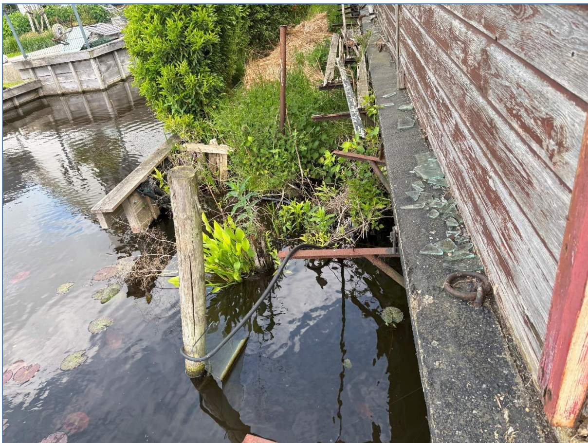
Afbeelding 8: deel van de oever niet meer effectief beschoeid aan de noordzijde van de woonark. Door ruime hoeveelheid vegetatie mogelijk toegankelijk voor amfibieën of muizen vanuit het water.
